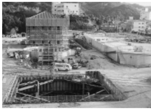
福良浄化センター（二月中旬）
